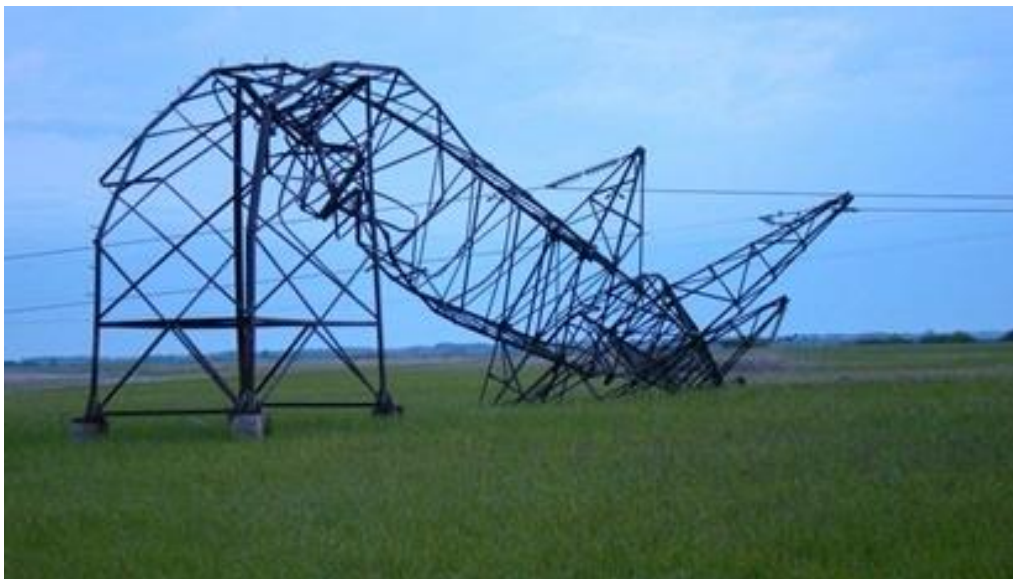
Рис. 2. Пример разрушенной металлической опоры
