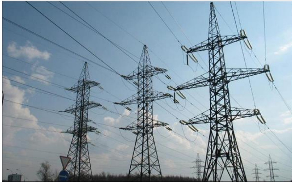
Рис. 1. Пример типовой высоковольтной линии электропередачи
